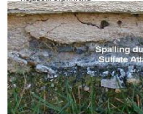
Разарање на површини бетона и појавом еtringита
